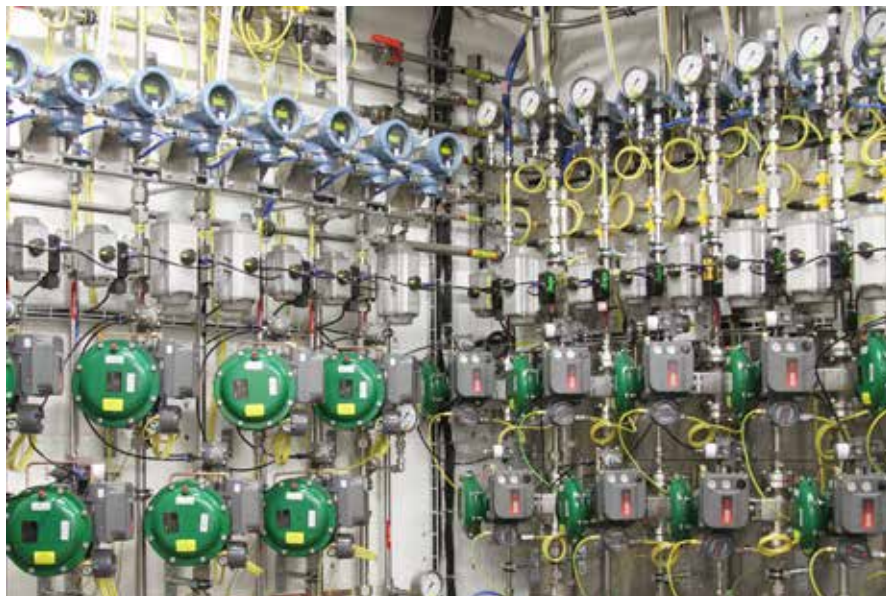
Moderne Gaseversorgungsanlage in einem Labor
