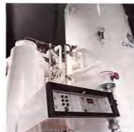
Im Trend: Luftzerlegungsanlagen nach dem Prinzip der Druckwechsel-Adsorption als Alternative zur Flüssigversorgung
