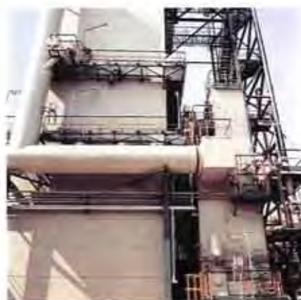
Wertvolle Edelgase: Bei der Luftzerlegung muß für jeweils 1 m 3 Krypton und Xenon 1 Million m 3 Luft zerlegt werden (Foto BASF)
