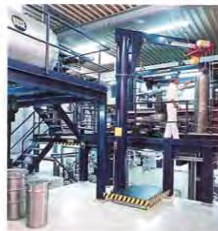
In Krefeld betreibt Buse Gase eine Anlage zur Hochdruckextraktion von Feststoffen mit Kohlendioxid
