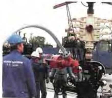
Erdgasförderung unter Druck aus 3000 Meter Tiefe mit Stickstoff
