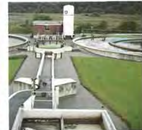
Sauerstoff aus dem Tank bringt schnelle Hilfe für überlastete Kläranlagen.
