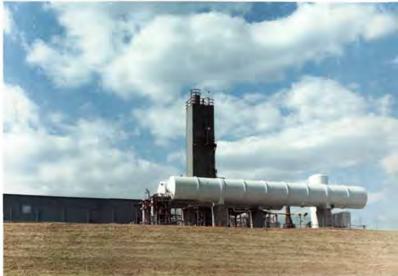
Ausbau der Gaseproduktion in den USA: die neue Luftzerlegungsanlage in Spartanburg, South Carolina
