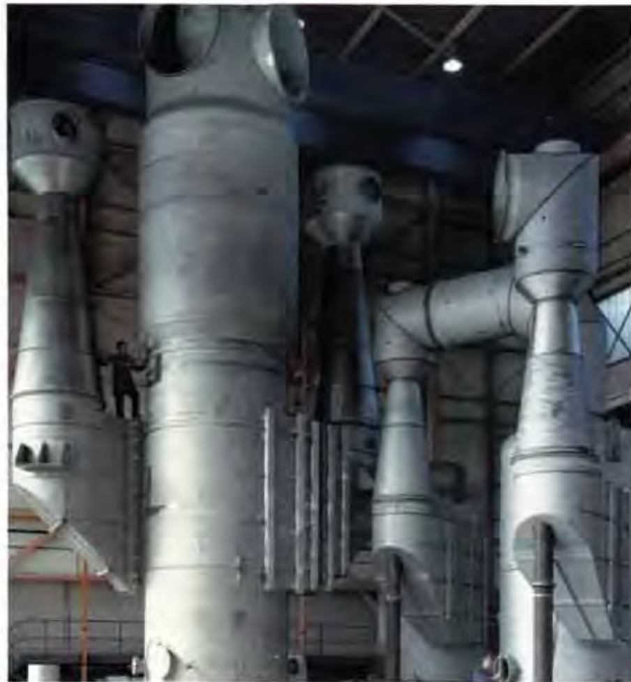
Die Abluft aus der Produktion wird in einer Waschanlage der Firma Griesser gesäubert. Die Konstruktion ist mit Schweißzusatz-Werkstoffen von Messer Griesheim geschweißt.
